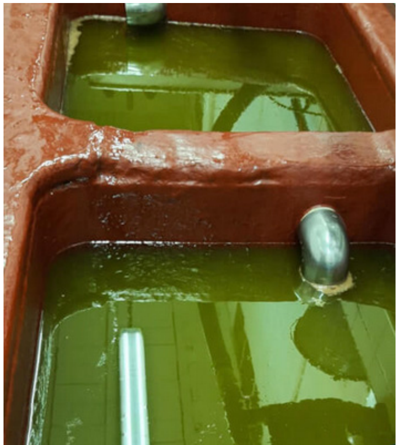
Piles o bassetes de decantació
